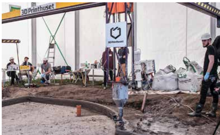
3D-printeren i færd med randsoklen – nederst, hvad det bliver til, når huset står færdigt i efteråret.
